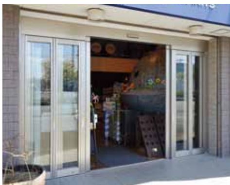
▲ 自動ドア開放時(自動操作)
