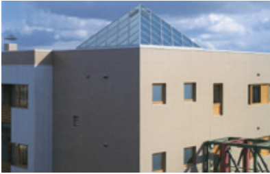
東海大学旭川校舎研究棟トップライト(北海道) 設計 大成建設 札幌支店 施工 北製作所 使用製品 WICTECほか
